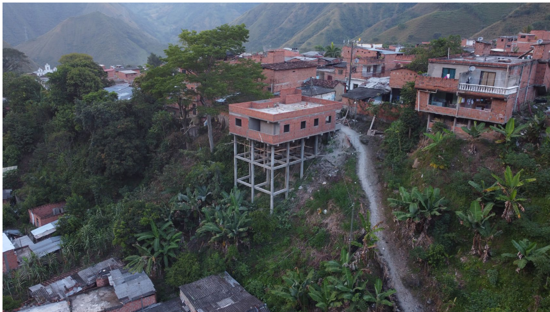
Figura 5-7. Fotografía de edificación sin cumplimiento de normas constructivas, municipio de Sabanalarga
